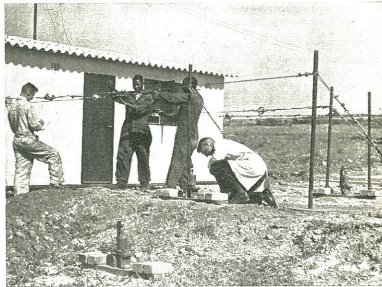
Bo: Proefhuis gebou op drie beton „kussings”, een by elk van die agterste hoeke en een in die middel voor; deur hierdie metode te gebruik word daar gehoop dat die uitwerking van die uitsit (oplig) van kleifondamente wat muurkrake veroorsaak in baie dele van die land, voorkom sal word.
